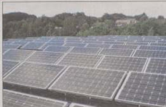
Das Foto zeigt die nwerk-Photovoltaikanlage auf der Sophie-Scholl-Schule in Kloster Oesede. PR-Foto
